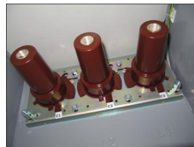
Конусы типа С Выключатель нагрузки 630А без трансформаторов тока
